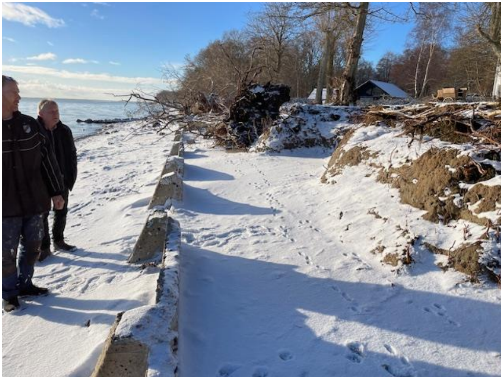
Figur 2-13 Lige udfør midten af Hovedbygningen set mod syd. Beskadiget betonmur med stor og dyb erosion, ~2 m dyb af jorden bagved muren.
