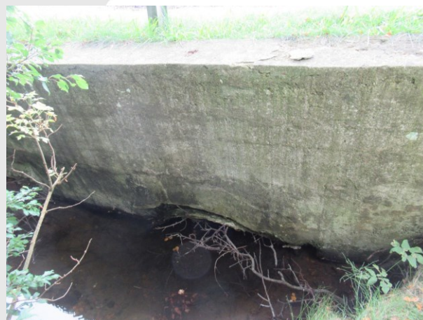
2. Facade mod øst. Rør i facaden er kraftigt nedbrudt
