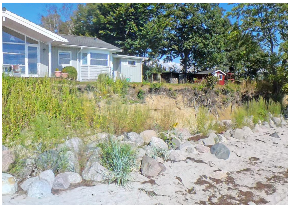
Figur 3-6 Eksempel på erosionskant og uvirksom skråningsbeskyttelse
