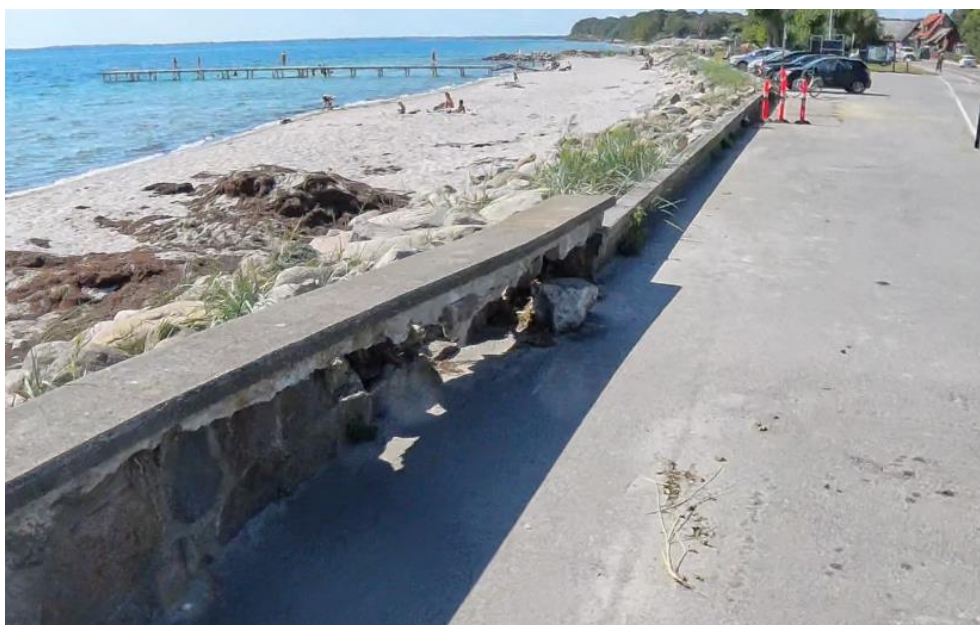
Figur 3-8 Eksempel på højvandsmur ved Strandhovedvej, der er blevet nedbrudt under stormflod, og dermed ikke længere er virksomt
