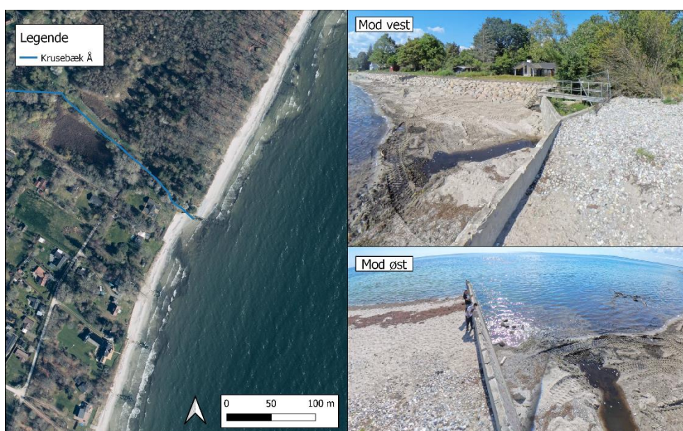
Figur 5-6 Nuværende tilstand af udløbet ved Kruse Bæk. Ortofoto fra foråret 2023. Øvrige fotos viser 'høfden' mod hhv. øst og vest og stammer fra kystinspektion i august 2024.
