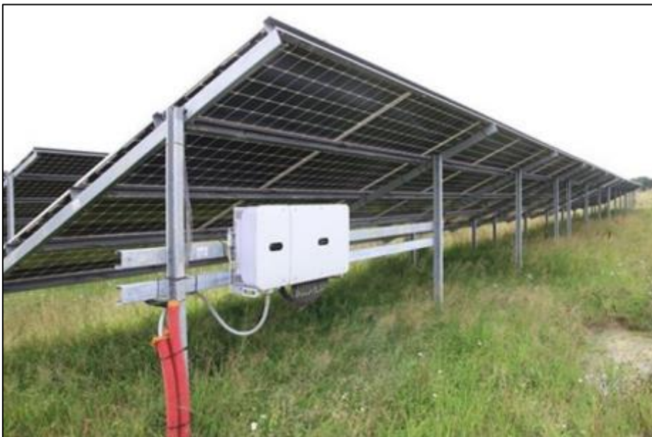
Figur 1.5.2. Solcellepaneler med eksempel på inverter.
