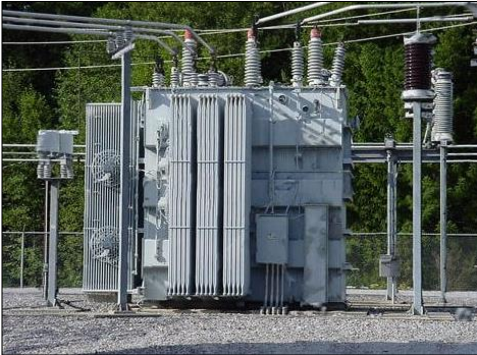
Figur 1.5.4. Eksempel på en koblingsstation/step-up transformer.
