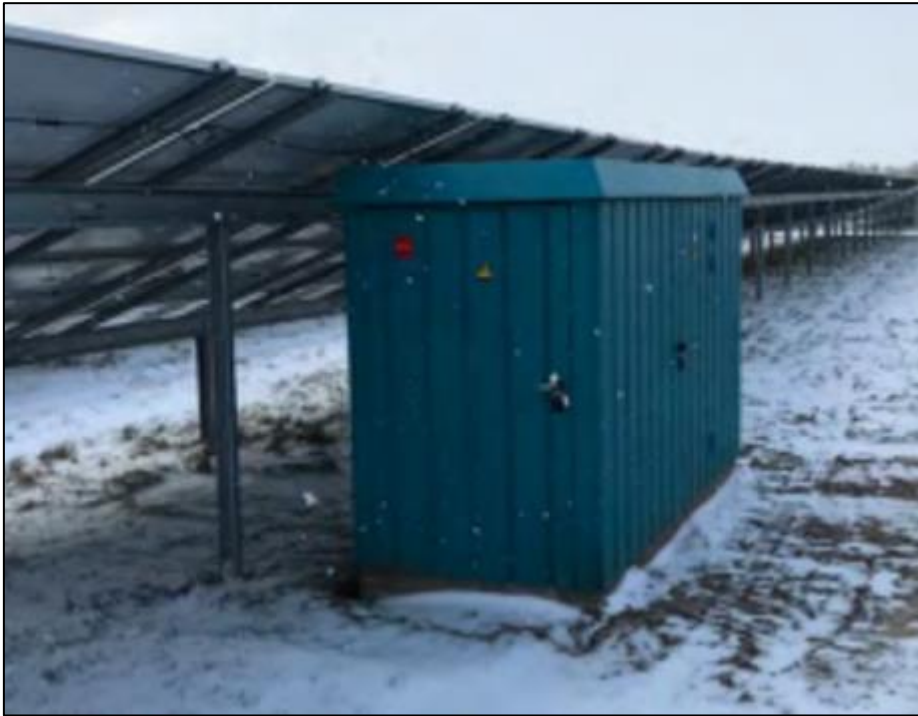
Figur 1.5.3. Solcellepaneler med eksempel på fordelingstransformer.
