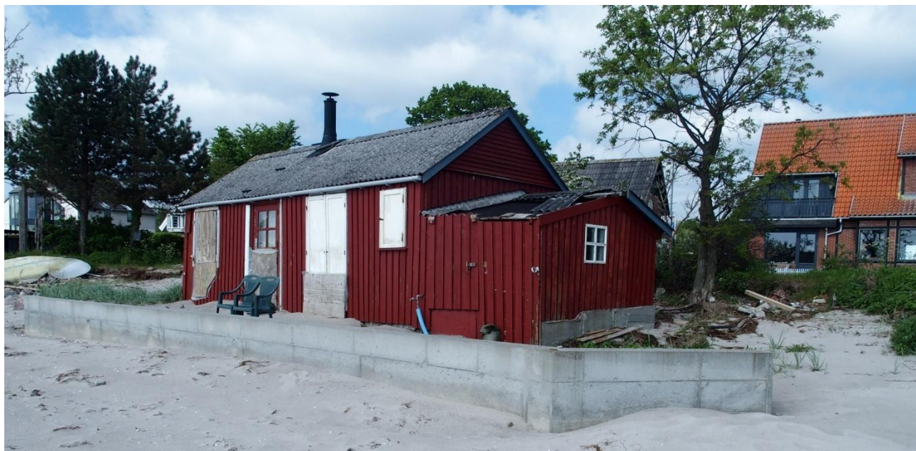
Figur 2-3 Bygning 3 ligger lavere end bygning 2, men er beskyttet af lav mur og kun let beskadiget ved stormen 2023.
