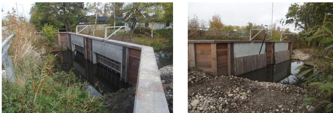
Figur 2-15 Skensved Å højvandssluse med tophængte sluseporte. Bagvandspumper er ikke monteret på billederne.
