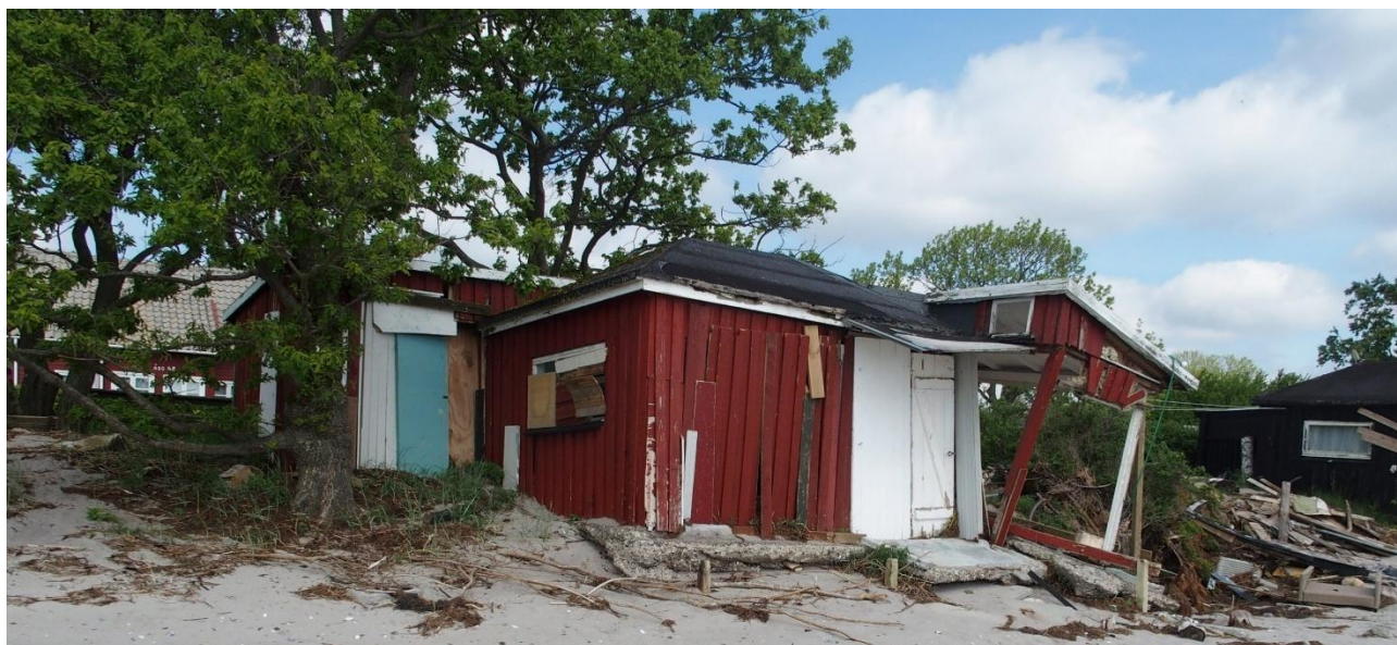
Figur 2-4 Bygning nr. 2, der ikke var beskyttet af lav mur blev voldsomt beskadiget af bølger ved stormen 2023
