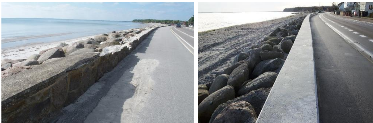
Figur 1-2 Højvandsmuren blev kraftigt beskadiget under stormen, men er siden renoveret af Faxe Kommune. Foto: Lynghus og Faxe Kommune.
