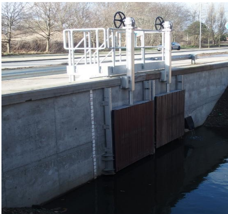
Figur 4-15 Manuelt betjent stigbordsluse med to porte på Karlstrup Mosebæk i Solrød. Portene er i åben stilling med port umiddelbart over vandløbets vandspejl. Portene er ved fuld åbning ikke synlige fra landsiden. Sluse fra Wintec.
