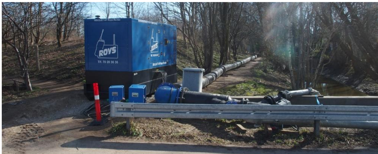
Figur 4-7 Selvansugende mobil pumpe med generator.
