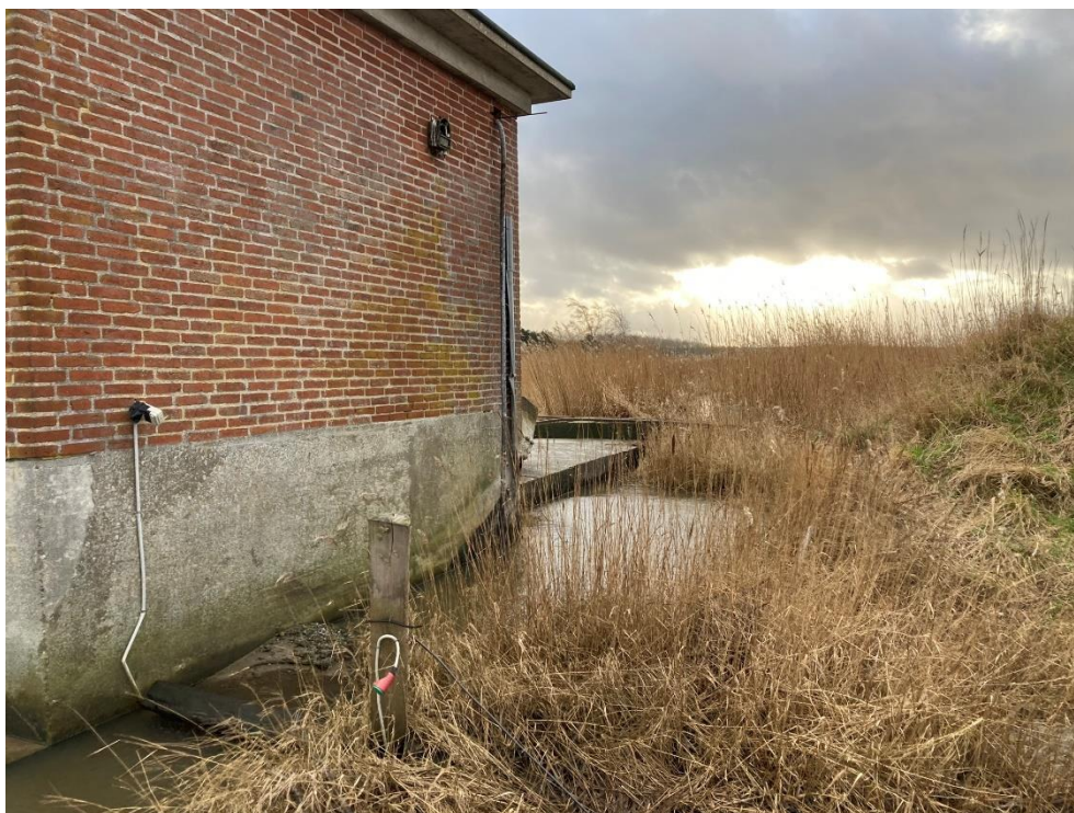
Figur 3-16 Vestsiden af pumpehuset, hvor diget også er delvist borteroderet.
