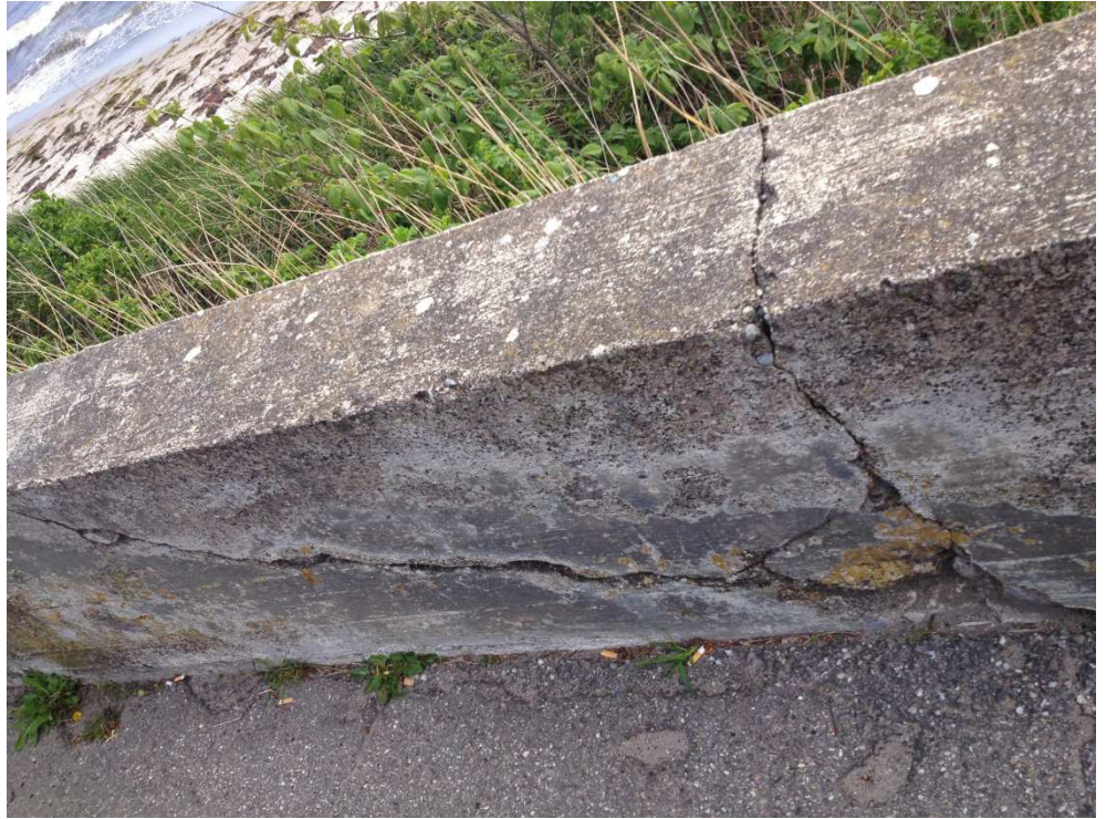
Figur A.26 Beskadigelse af støttemur.
