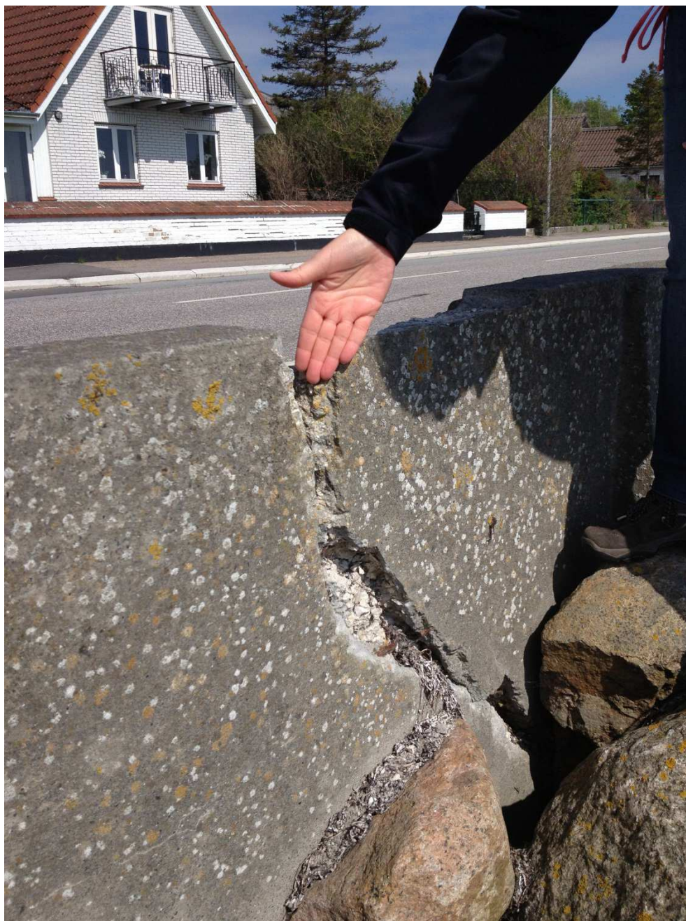
Figur A.7 Beskadigelse af støttemur.
