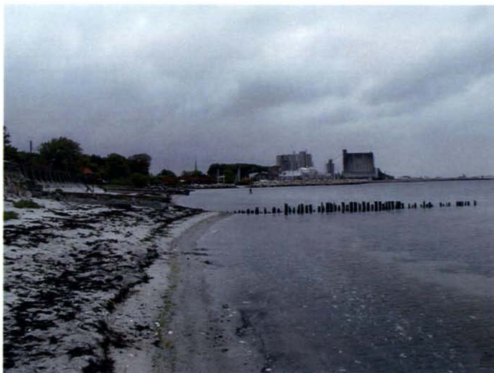
Foto 17: Stranden sydvest for havnen med nedbrudte h fder uden virkning. Overgangen fra betonmur til betonmuren med sten ses til venstre.
