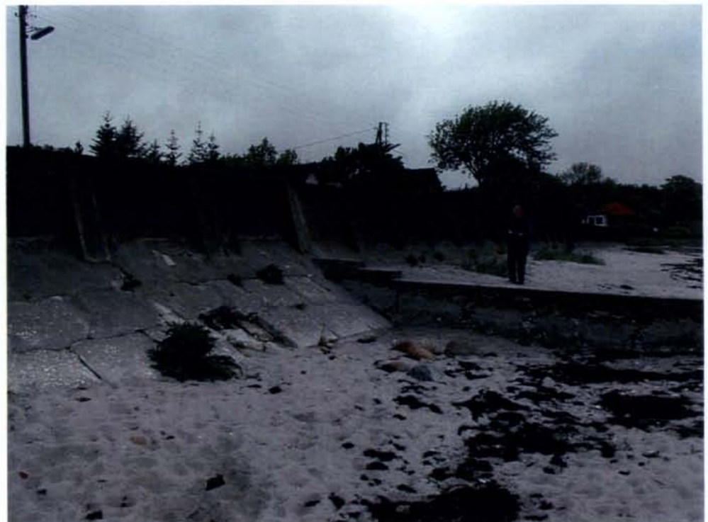
Foto 14: Beskadiget beton støttemur på strækningen umiddelbart sydvest for havnen. Foto taget mod nord.
