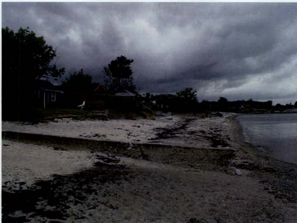
Stranden sydvest for Fakse å ud for Rosendal Gods' sommerhuse, der er fremspring i betonmur og en nedbrudt hofde.
