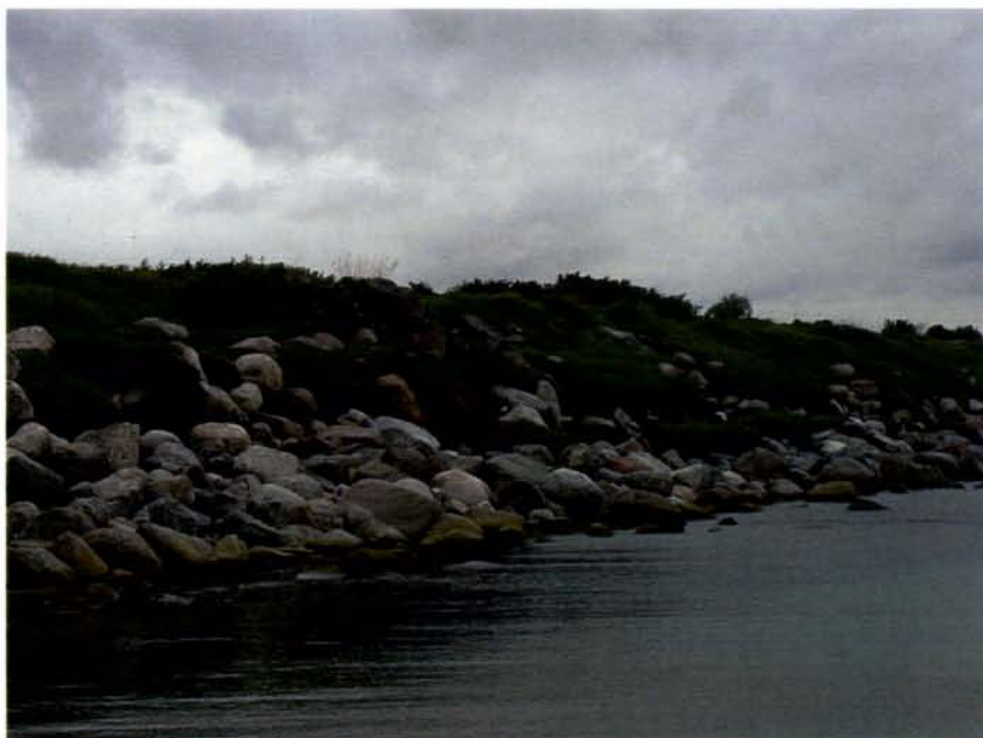
Foto 6: Stenkastningen ved havnen lige nordøst for sandfangsmolen.
