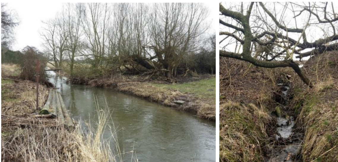
Figur 6 Tryggevælde Å (o8301_d) Foto 1: St. 10800, foto er taget nedstrøms. I venstre side ligger den ituskyllede spang. Foto 6: St. 10940. Fotoet viser de to drænudløb, med udløb omkring to meter over vandløbet.
